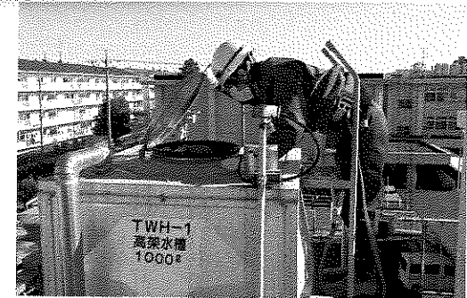
【小規模貯水槽水道の点検】
