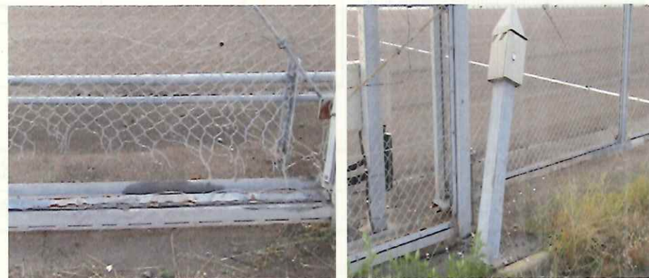
【 事故により破損した埠頭保安設備 】
