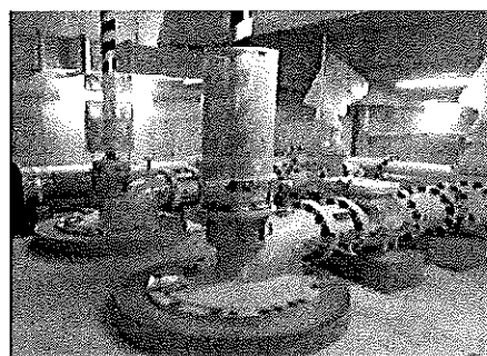
②送水ポンプ 口径400mm 2台
