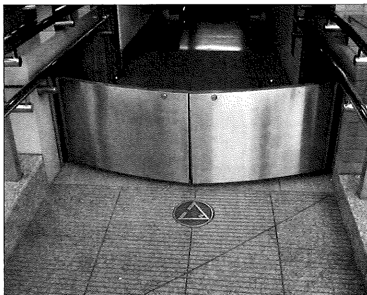
駅出入口止水板
