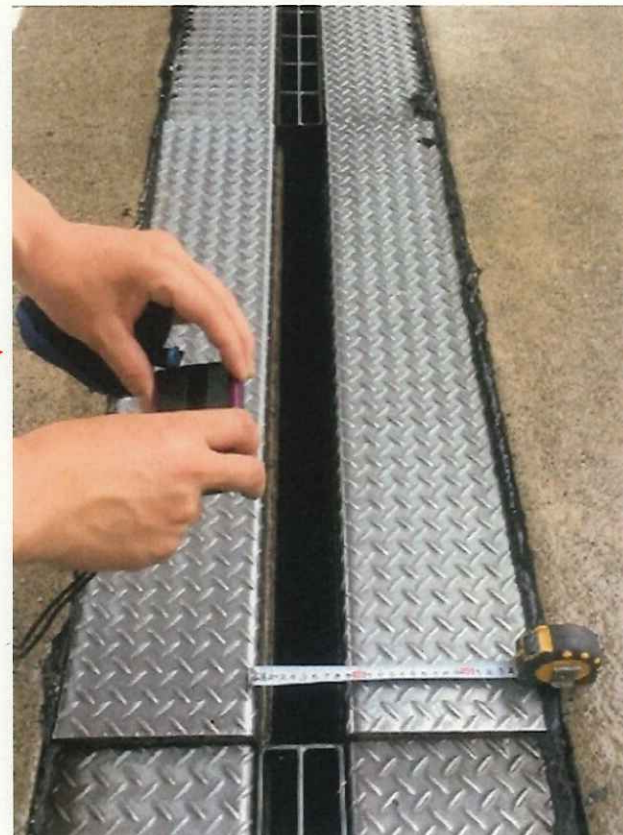
【 グレーチング蓋落下詳細 】
