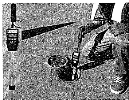
新たな漏水探知器
