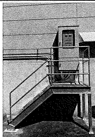
鳴海水処理センターの耐水化
