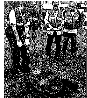
地下式給水栓の操作
