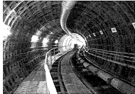
写真：雨水調整池の建設現場 ／中村中部雨水調整池（工事中）
