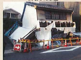
倒壊した家屋
