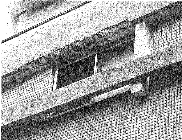
壁の一部が損傷した市営住宅。具体的な建て替え計画はこれからだ。市内で
