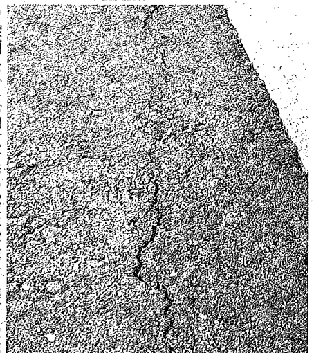
工事後に道路が盛り上がり、ひびの入った現場。埋め戻し材に鉄鋼スラグが混ざっていた。名古屋市中区で28日、岡大介撮影
